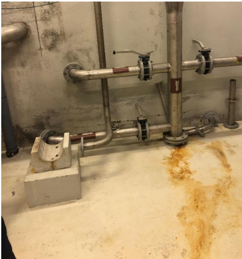
Figur 4: Innlekk av regnvann i UV-kjeller har ført til forvitring på betonggulv.
