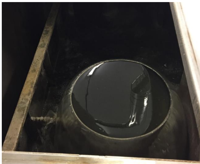
Figur 4: Eksempel på fordelingskasse, Hartevatn RA
