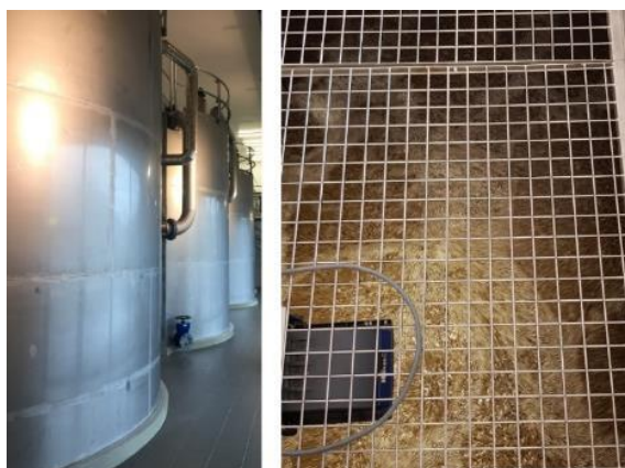
Figur 6: Utvendig og innvendig bilde av MBBR-tanker i stål. Hartevatn RA
